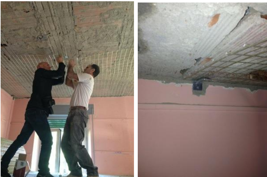
9, 10. Fase di posa della rete in GFRP e tassellatura per mettere in tensione i materiali in aderenza alla superficie da consolidare.
